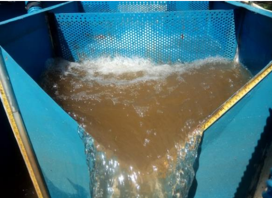
Gbr. 2. Pengukuran debit menggunakan weir meter vnotch 90°
